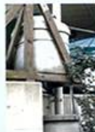
雨水タンク。タンク容量が小さいので、3つ並べてある。産業廃棄物のプラスチックタンクを使っている。手前の配管が雨水用のもの。
